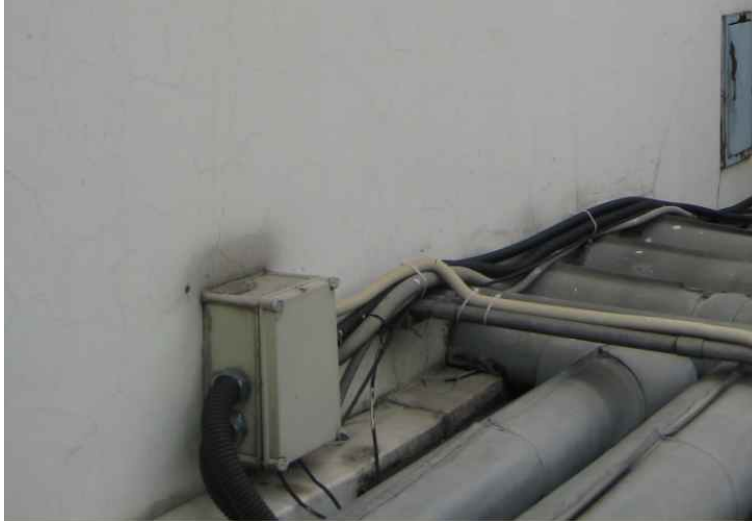
그림 3-5) 옥상으로 부터의 동축선 인입관로가 없어 EPS/TPS실 천정을 뚫어 시설한 경우(위 사진), 옥상 기계실을 통한 동축선의 인입의 경우(아래 사진)
